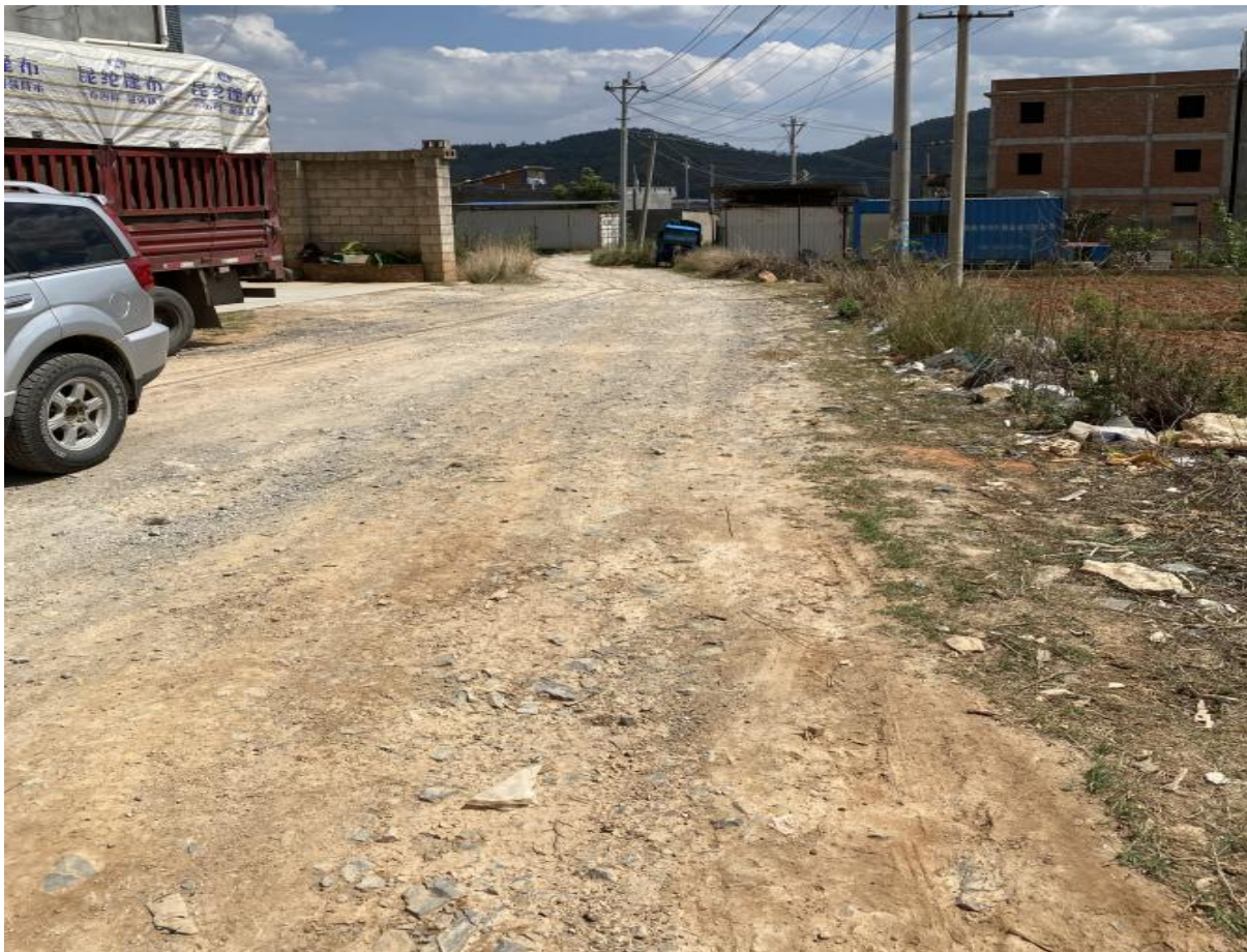
照片 4-8 纳古灌区分干线临时道路现状
